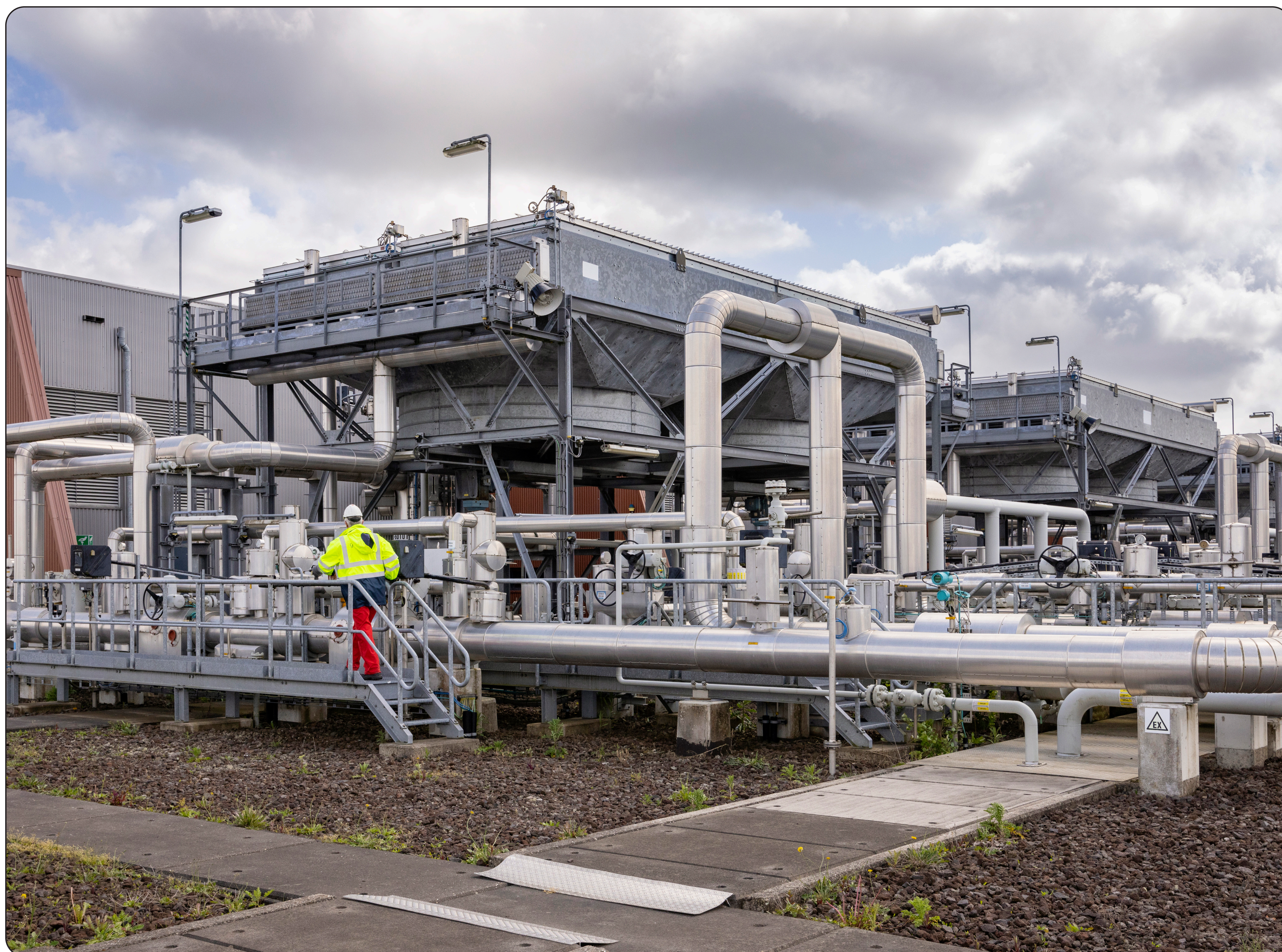
Koelerbanken op de huidige installatie van EnergyStock
